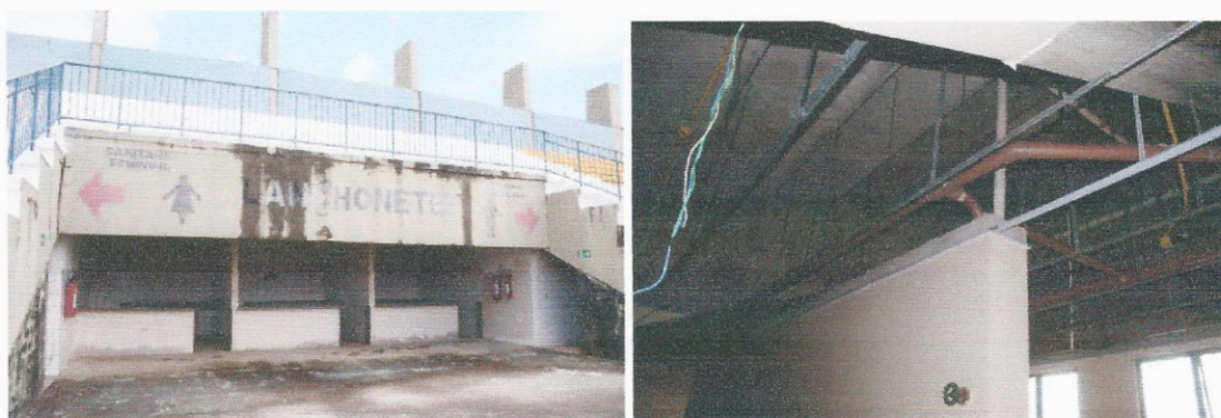
ILUSTRAÇÃO 9 – LANCH. E BANHEIROS (SEM FORROS E MAL CONSERVADOS)
