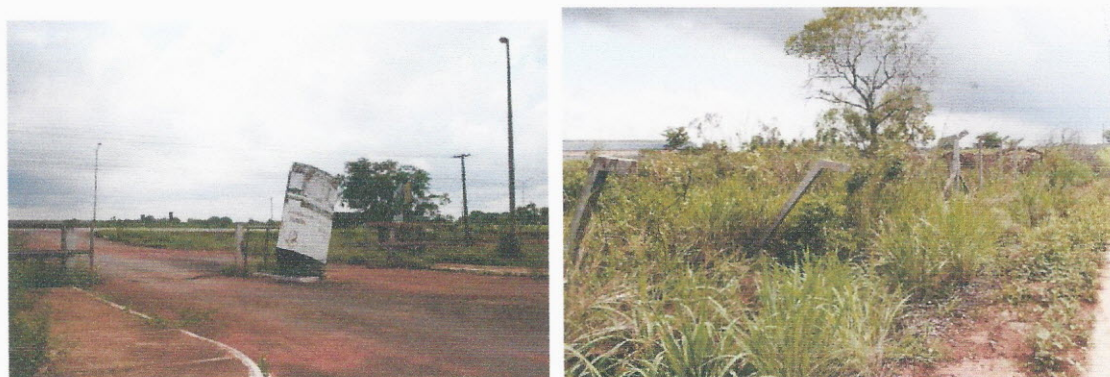
ILUSTRAÇÃO 6 – PORTÃO DE ENTRADA INUTILIZADA E ALAMBRADO AVARIADO
