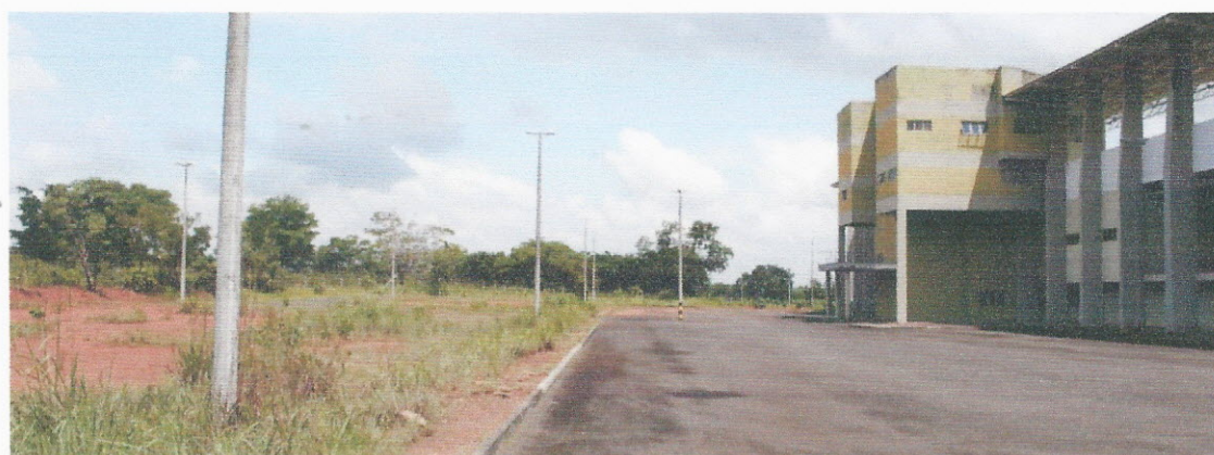
ILUSTRAÇÃO 23 – POSTES COM LUMINÁRIAS NO ESTACIONAMENTO DOS FUNDOS DO ESTÁDIO
