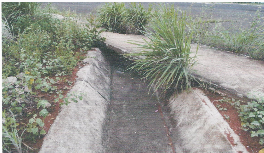
ILUSTRAÇÃO 15 – CALHAS CONCRETO P/ CONDUÇÃO DE ÁGUAS PLUVIAIS COM ENTRADA ATRAVÉS DE BOCA-DE-LOBO
