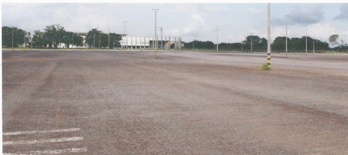
ILUSTRAÇÃO 16 – ASFALTO DO ESTACIONAMENTO MAIOR (ESTÁDIO AO FUNDO)
