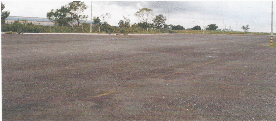
ILUSTRAÇÃO 28 – SINALIZAÇÃO HORIZONTAL BASTANTE DETERIORADA
