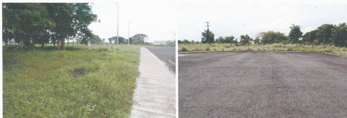
ILUSTRAÇÃO 2 – FOTOGRAFIAS DO ESTADO DE DEPREDÇÃO DA GRAMA EXTERIOR (PRESENÇA MASSIVA DE CAPIM E MATO)
