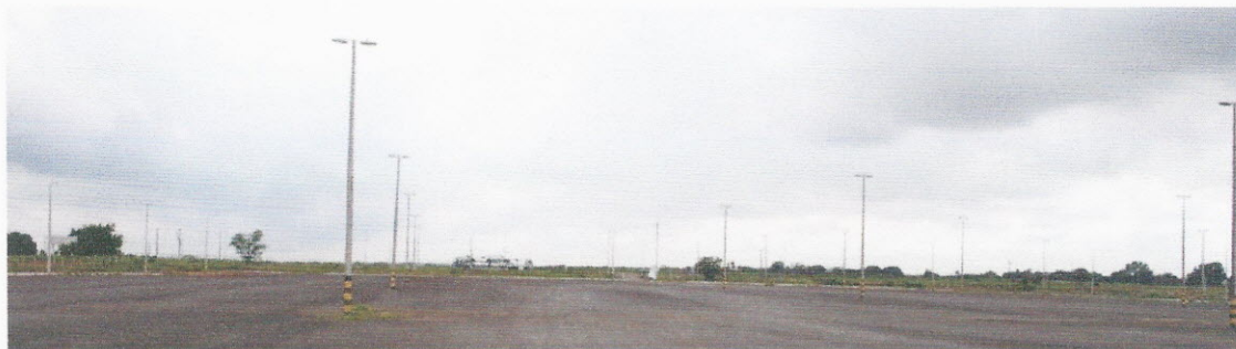
ILUSTRAÇÃO 22 – POSTES COM LUMINÁRIAS NO ESTACIONAMENTO MAIOR
