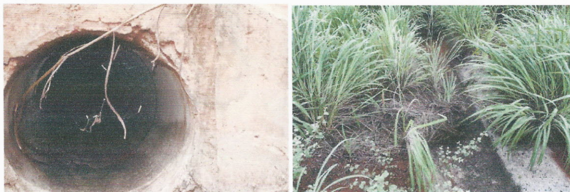
ILUSTRAÇÃO 5 – TUBULAÇÃO PLUVIAL SEM MANUTENÇÃO DE LIMPEZA
